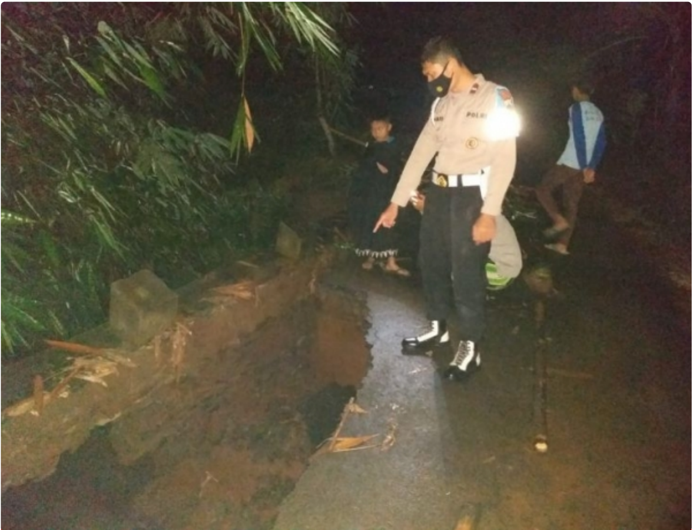
Hujan Deras Sebabkan Jalan di Pengadegan Ambles
